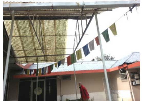
Dit is de huidige constructie voor een half dak van gammele plastic golfplaten.
